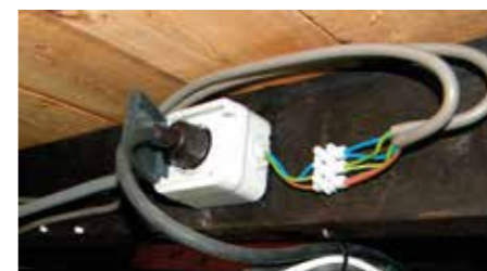
Voedingskabels onder de vloer naar de verwarmingslinten voor de riool- en drinkwaterslangen tussen ark en steiger: destijds zelfs door een installateur geplaatst maar tegenwoordig zo in de open lucht net niet aanvaardbaar.
