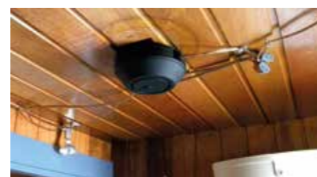
12-volt voeding aan halogeenspotjes: de regeling voor laagspanning stelt geen hoge eisen eisen, maar deze blote lasklemmen in een natte ruimte kunnen net niet door de beugel.
