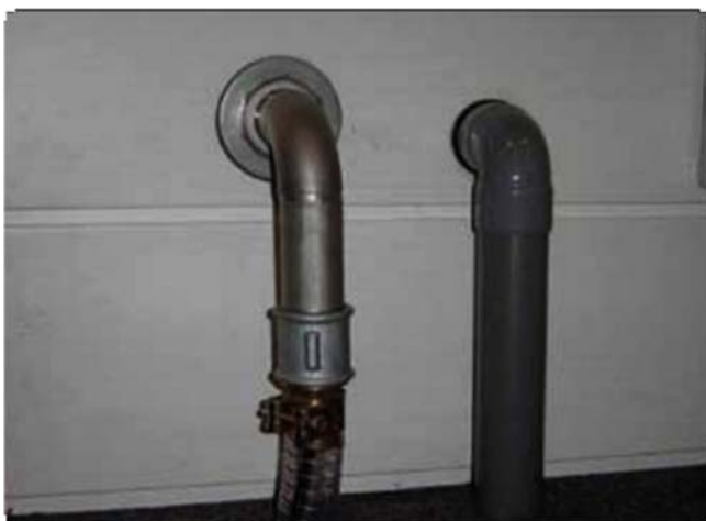
Wanddoorvoer (links) en ontluuchtingsleiding
